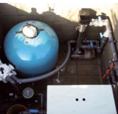
En teknikstation bestående af et mekanisk sifilter nederst til højre, en tørmonteret pumpe nederst til venstre og et Beadfilter øverst til venstre. Øverst til højre ses et UV-lys til bekæmpelse af sygdomsfremkaldende vira og bakterier. I midten til højre ses tre returløb, hvorfra vandet ledes tilbage til svømmesøen. Teknikstationen kan skjules f.eks. under en træterrasse.
